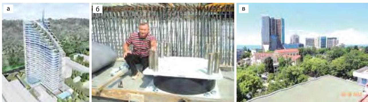
Рис.12. Высотное здание 27-этажной гостиницы в процессе строительства в г.Сочи: а — перспектива первоначального варианта здания; б — устройство РМО со свинцовым сердечником; в — новый вид здания.
